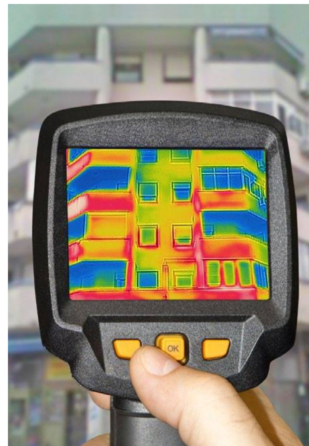
Imagen de cámara termográfica sobre los puentes térmicos producidos en balcones tradicionales de hormigón.
